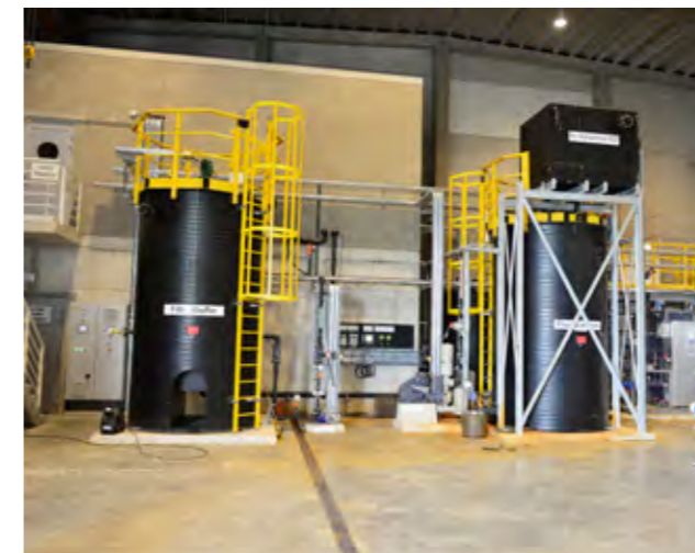
De semi-industriële installatie in De Blankaart
